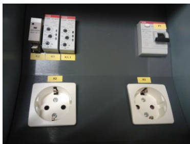
Bild från insidan av IISI S6 PRO elcentralen
